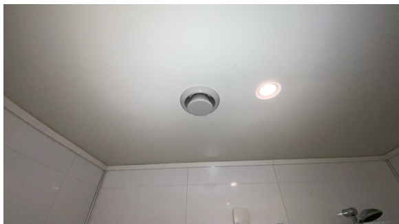
Avtreksventil i himling
