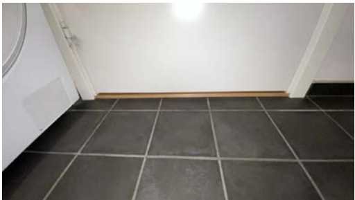
Tilluftsspalte under dør
