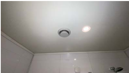
Avtreksventil i himling
