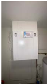
Balansert ventilasjonsaggregat er plassert på vegg inne på teknisk rom
