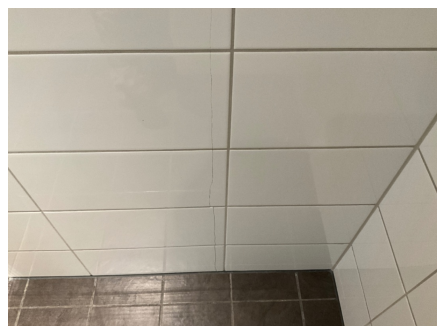
Sprekk i flere fliser.
