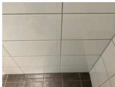
Sprekk i flere fliser.
