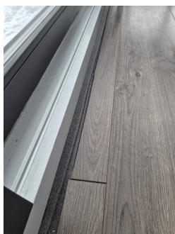
Ikke lagt laminat helt inntil terrassedør.
