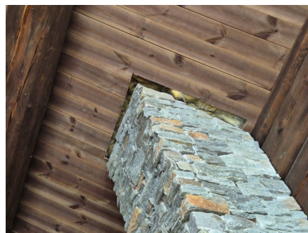
Mangler omramning/listverk rundt pipe.
