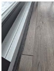
Ikke lagt laminat helt inntil terrassedør.
