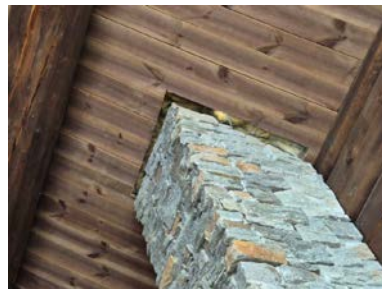
Mangler omramning/listverk rundt pipe.
