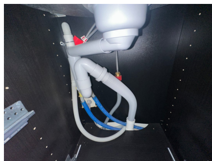
Røropplegg i kjøkkenbenk
