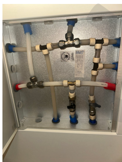
Samleskap med rørkurser og stoppekraner
