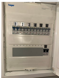
Sikringsskap med automatsikringer.
