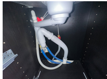
Røropplegg i kjøkkenbenk
