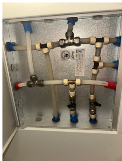
Samleskap med rørkurser og stoppekraner
