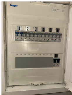
Sikringsskap med automatsikringer.
