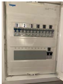
Sikringsskap med automatsikringer.
