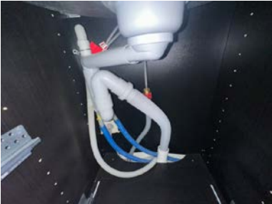
Rørøpplegg i kjøkkenbenk
