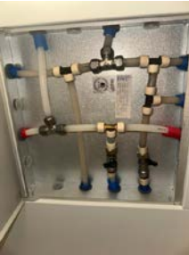
Samleskap med rørkurser og stoppekraner
