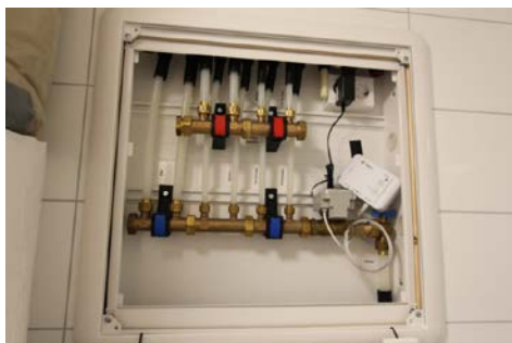
Fordelingsskap for vannledninger.
