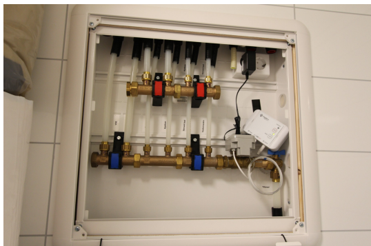
Fordelingsskap for vannledninger.
