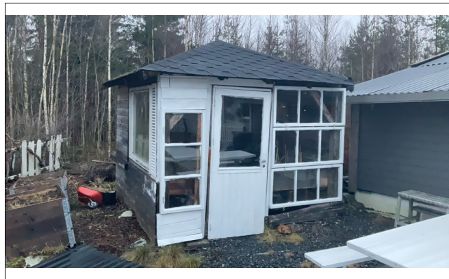
Paviljong/drivhus på eiendommen. Bygningen er i dårlig forfatning.
