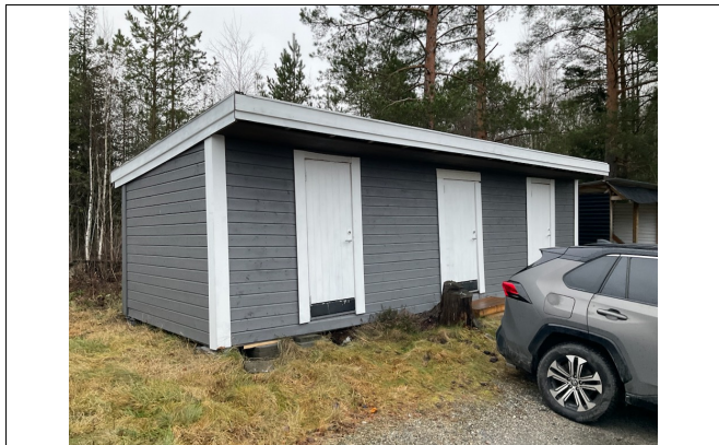
Bodbygning på eiendommen. Bygningen har vesentlige skjevheter pga. dårlig fundamentering.
