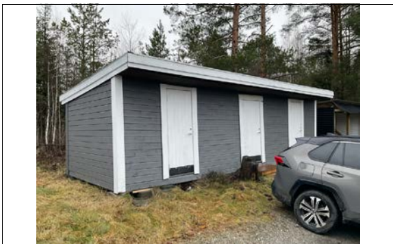
Bodbygning på eiendommen. Bygningen har vesentlige skjevheter pga. dårlig fundamentering.
