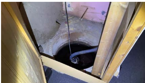
Brønn i kjeller med drenspumpe.
