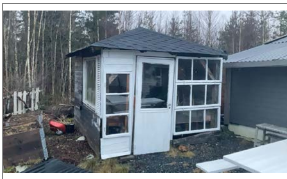
Paviljong/drivhus på eiendommen. Bygningen er i dårlig forfatning.
