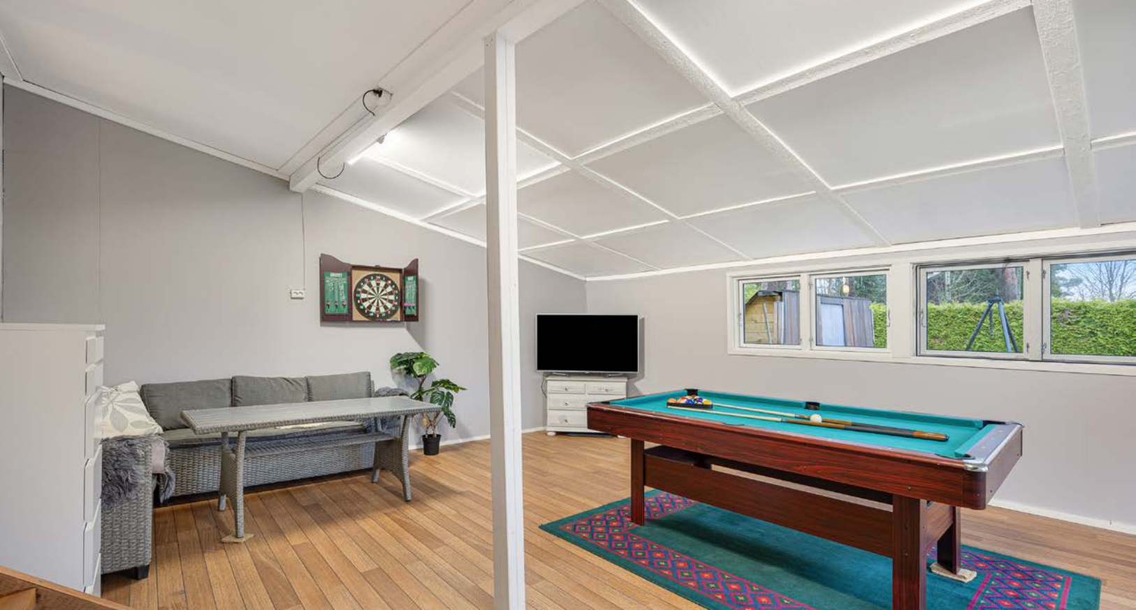
Tilbygget vinterhage (ikke byggemeldt og godkjent).
