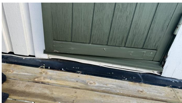
Bilde viser terrassedør med behov for utskifting.
