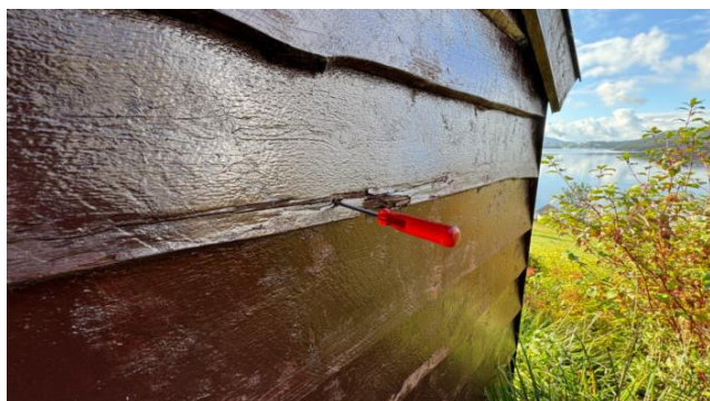
Bilde viser levegg med råteskader og behov for utskiftninger.
