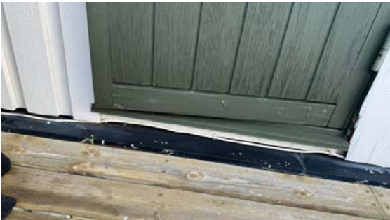
Bilde viser terrassedør med behov for utskifting.
