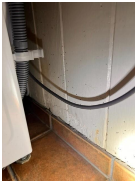
Råteskade i trepanel og tegn til stripet borebiller.
