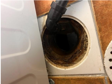
Sluk fra byggeår i støpejern og manglende membran i gulv.
