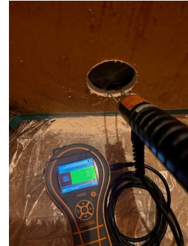
Fuktmåling i vegg mot våtsone.
