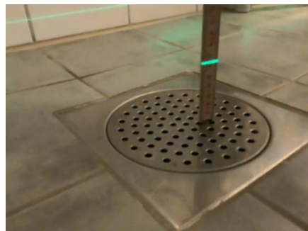
Totalt fall fra topp flis ved dør til topp slukrist er 22 mm.
