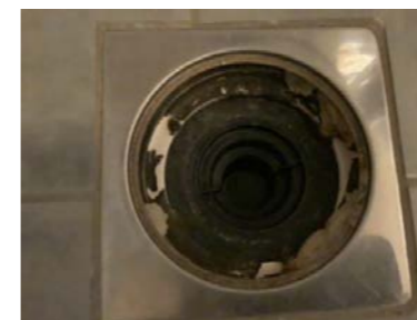
Kontroll av sluk. Det er synlig membran under klemring i sluk.
