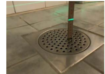
Totalt fall fra topp flis ved dør til topp slukrist er 22 mm.
