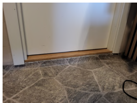
Spalte under dør
