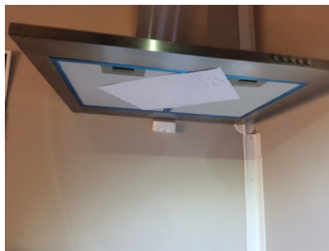
Avtrekk testet og fungerer bra
