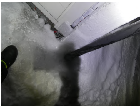
Isdannelse som følge av lekkasje på nedløpsrør
