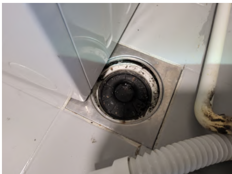
Sluk hvor man kan se at skruer mangler på klemring, og ingen manskjett eller membran
