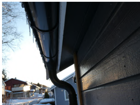
Nedløpsrør er gått av i en sammenføyning
