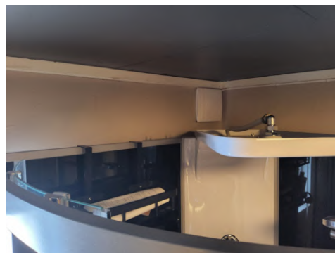
Vifte over dusjkabinett
