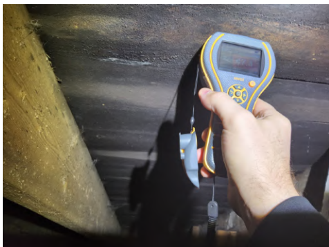
Måler 47 vektprosent fukt i taktro
