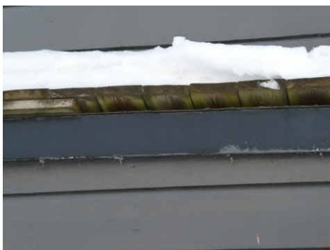
Tekking og beslag fra siden
