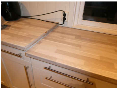
Trapping/høydeforskjell på benkeplate
