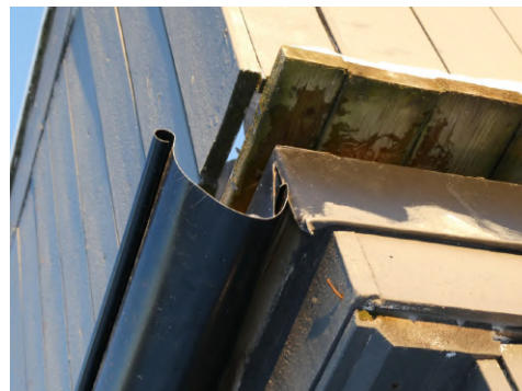
Tekking og beslag fra siden
