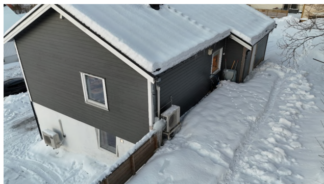
Dronebilde av snødekket ta. Ikke mulig å inspisere takteking.
