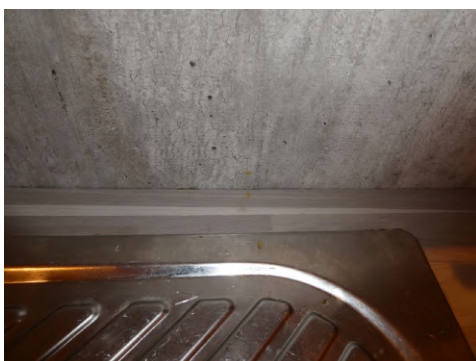
Mangler fugemasse ved benkeplate
