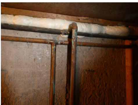
Kobberrør i krypekjeller
