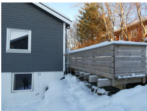
Isdannelse som følge av lekkasje på nedløpsrør
