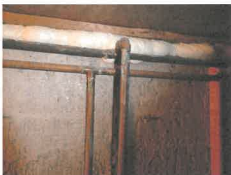
Kobberrør i krypekjeller
