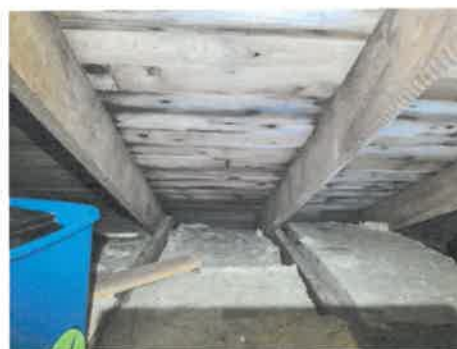
Taktro av tre er misfarget etter lengre tids fuktbelastning.
