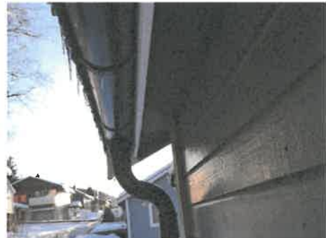
Nedløpsrør er gått av i en sammenføyning
