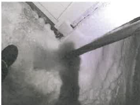
Isdannelse som følge av lekkasje på nedløpsrør
