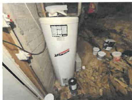
Varmtvannstank i krypekjeller.
