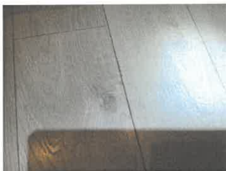
Gulv kjøkken 1 etg. mindre skader
