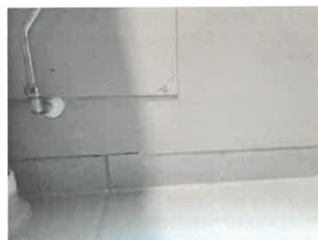
Ikke fagmessig montering av veggplater
