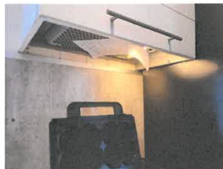
Avtrekk testet med papirark. Fungerer bra KJELLER > KJØKKEN
