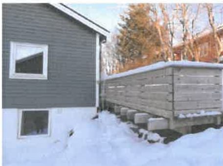
Isdannelse som følge av lekkasje på nedløpsrør
