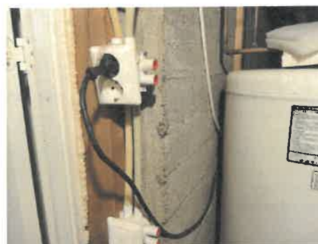
Varmtvannstank i krypekjeller.
