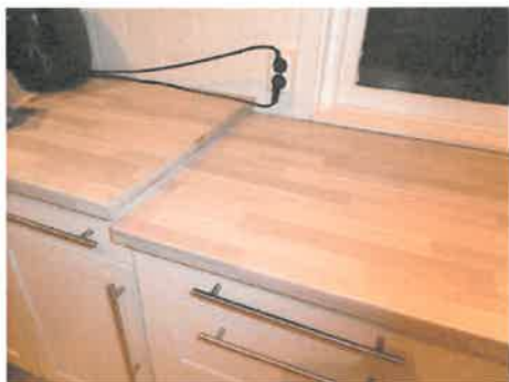
Trapping/høydeforskjell på benkeplate
