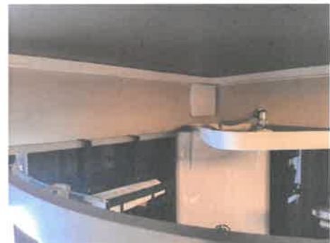
Vifte over dusjkabinett ETASJE > BAD
