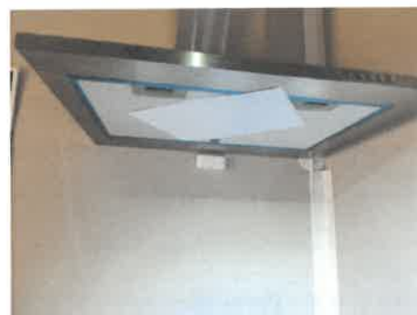
Avtrekk testet og fungerer bra
