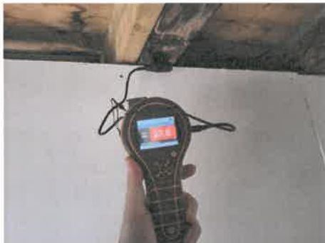
Forhøyede fuktverdier og råteskader i bjelker i garasjetak
