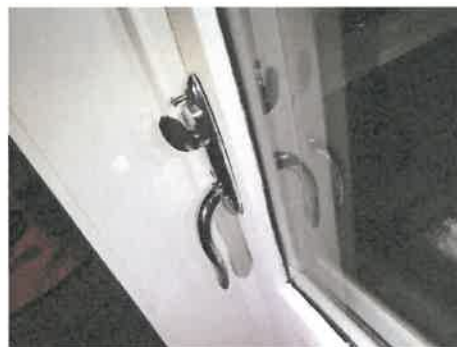
Defekt låsemekanisme balkongdør
