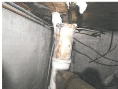
Avløpsrør i krypekjeller
