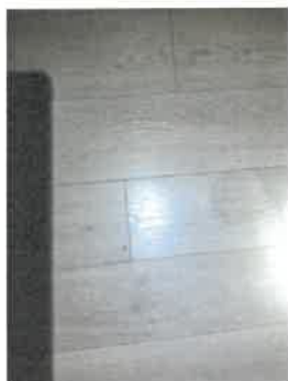
Gulv gang 1 etg. Mindre skader
