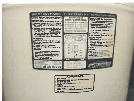
Varmtvannstank i krypekjeller.
