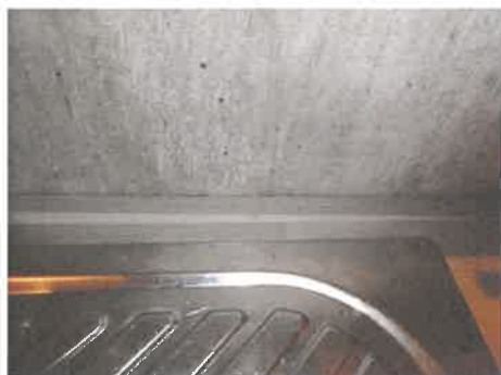
Mangler fugemasse ved benkeplate
