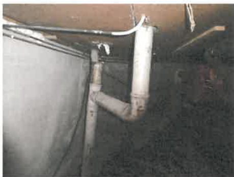
Avløpsrør i krypekjeller
