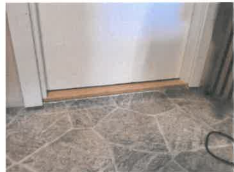
Spalte under dør
