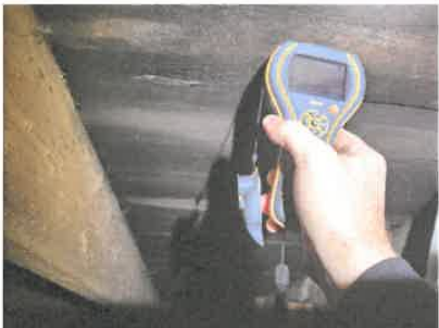
Måler 47 vektprosent fukt i taktro
