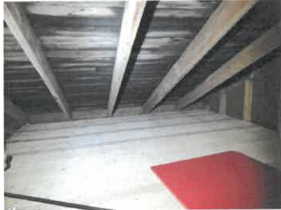
Taktro av tre er misfarget etter lengre tids fuktbelastning.
