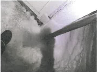
Isdannelse som følge av lekkasje på nedløpsrør
