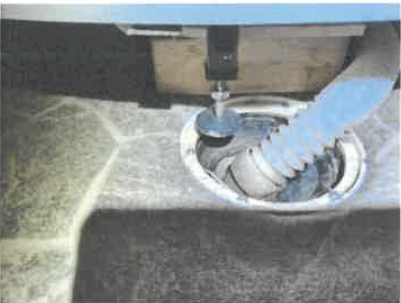
Sluk ETASJE > BAD
