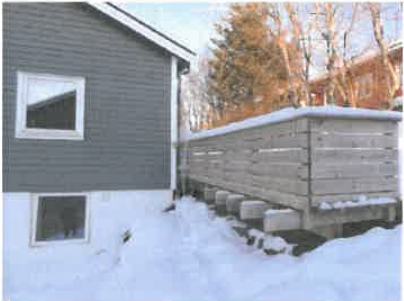
Isdannelse som følge av lekkasje på nedløpsrør
