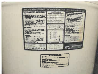
Varmtvannstank i krypekjeller.
