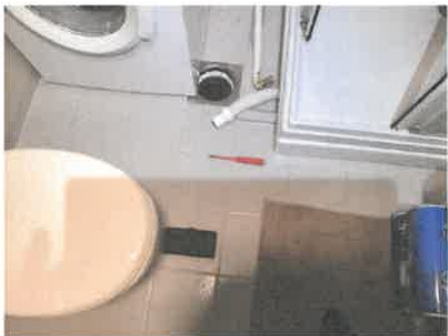
Sluk hvor man kan se at skruer mangler på klemring, og ingen manskjett eller membran KJELLER > BAD
