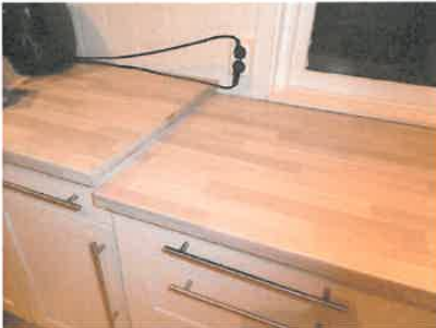
Trapping/høydeforskjell på benkeplate
