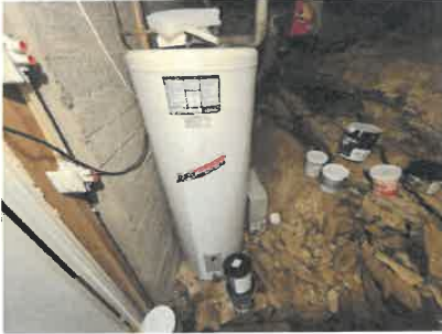
Varmtvannstank i krypekjeller.
