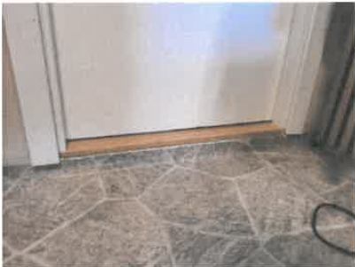
Spalte under dør
