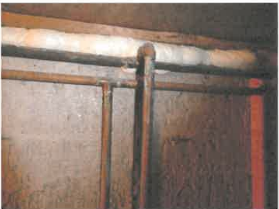
Kobberrør i krypekjeller
