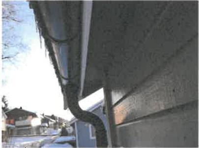
Nedløpsrør er gått av i en sammenføyning
