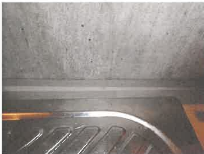
Mangler fugemasse ved benkeplate
