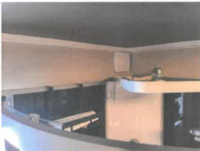
Vifte over dusjkabinett ETASJE > BAD
