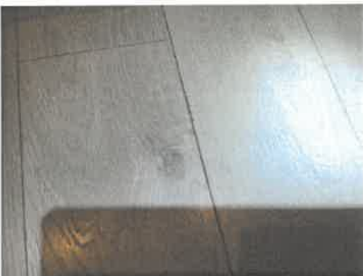
Gulv kjøkken 1 etg. mindre skader
