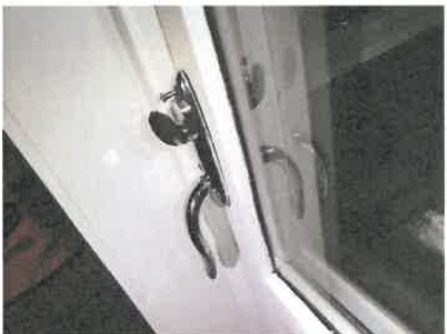
Defekt låsemekanisme balkongdør
