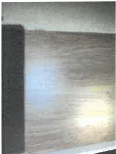
Gulv soverom 1 etg. Mindre skader
