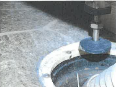
Sprekk i klemring og man kan se at belegg ikke kommer ut av klemringen slik det bør gjøre. Det er dermed ikke mulig å fastslå hvor belegget er avsluttet.
