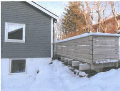
Isdannelse som følge av lekkasje på nedløpsrør
