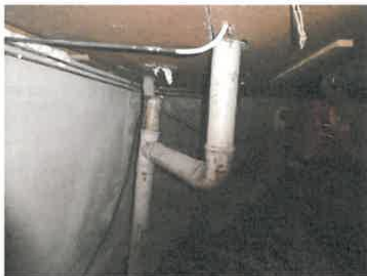
Avløpsrør i krypekjeller
