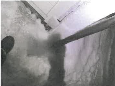
Isdannelse som følge av lekkasje på nedløpsrør
