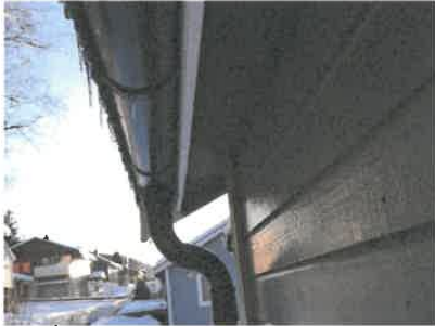
Nedløpsrør er gått av i en sammenføyning
