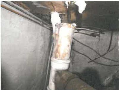
Avløpsrør i krypekjeller
