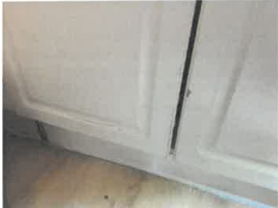
Fuktskadete skapdører KJELLER > KJØKKEN
