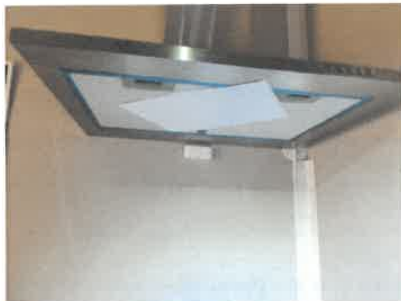
Avtrekk testet og fungerer bra
