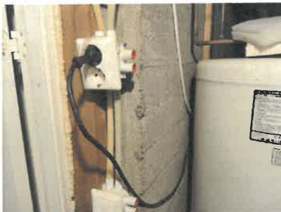
Varmtvannstank i krypekjeller.
