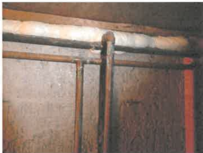
Kobberrør i krypekjeller
