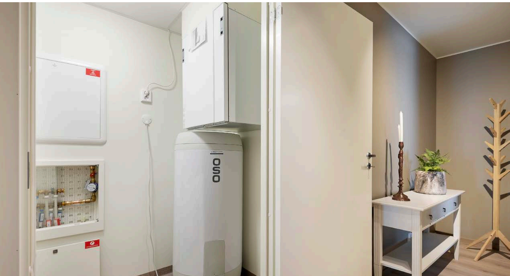
Teknisk rom/ bod.
