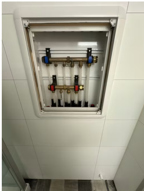
Vannrør med rør i rør system fra fordelerskap plassert på bad og frem til sanitærinstallasjoner på baderom og kjøkken.
