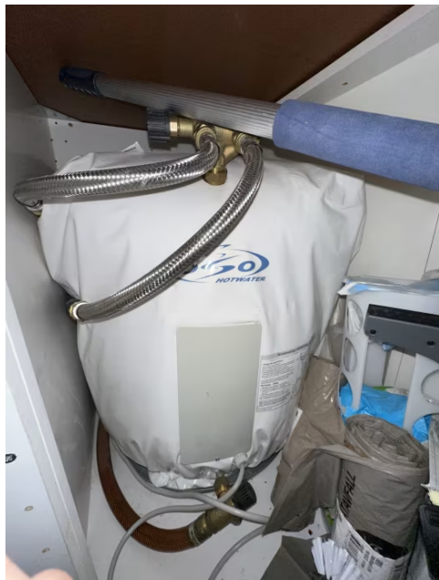
Viser bereder plassert i hjørneskap på kjøkkenet.
