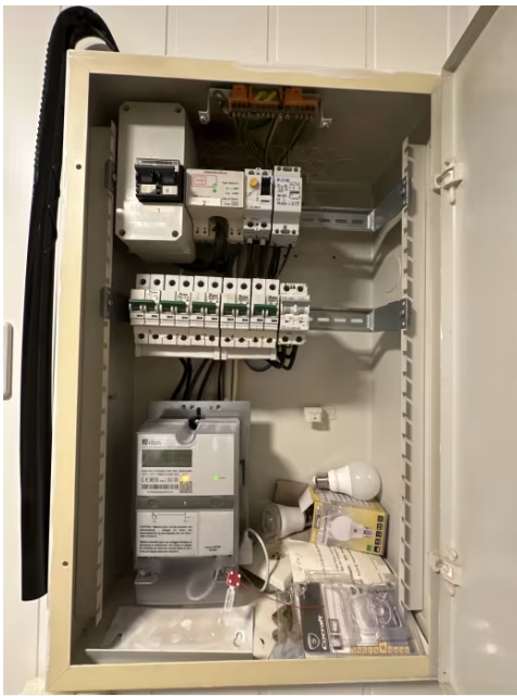
Viser sikringssskap i gang.
