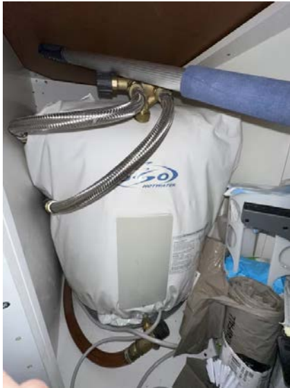
Viser bereder plassert i hjørneskap på kjøkkenet.
