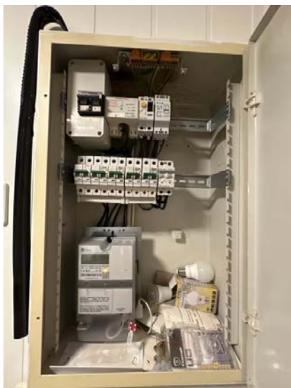
Viser sikringssskap i gang.
