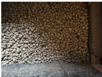
Viser ekskrementer av rotte under luke i entre.
