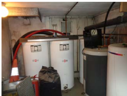
Varmtvannsberedere i kjeller.
