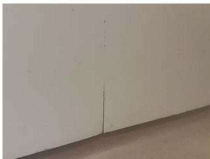
Noe oppsprekk mellom platene på vegger.
