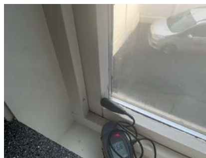
Det er målt fuktverdier i enkelte vinduer.
