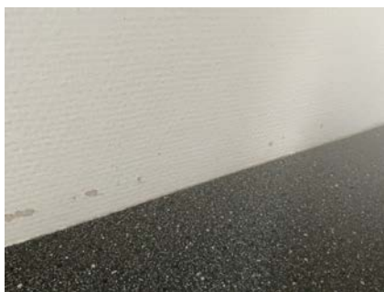
Det mangler noen fuger mellom benkeplater og vegg.
