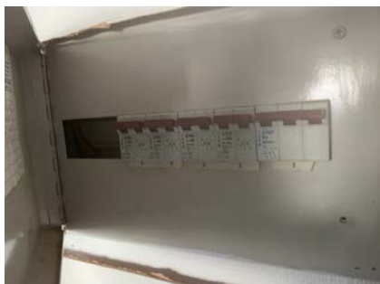
Sikringsskap i garderobeskap på kjøkken.
