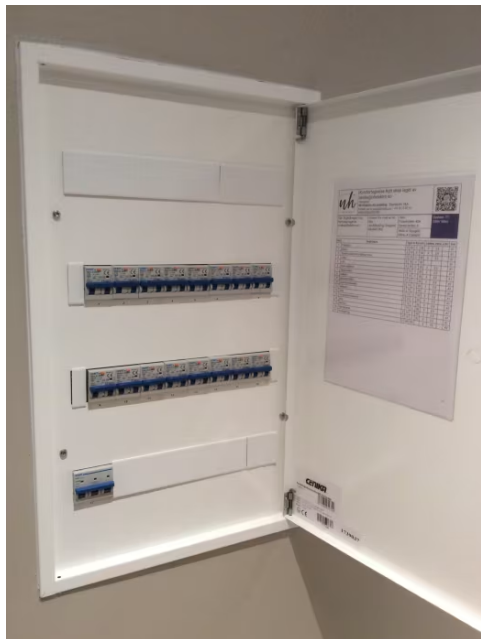
Komplett nyere elektrisk anlegg i boligen.
