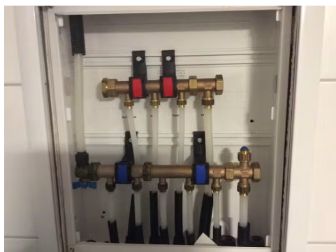
Rørskap i utleiedel.
