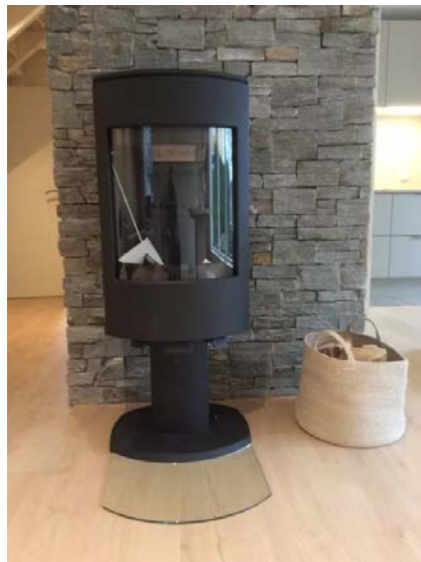
Ny ubrukt vedovn i stue.
