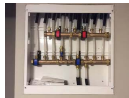
Nytt Rørrørapplegg fra 2023.
