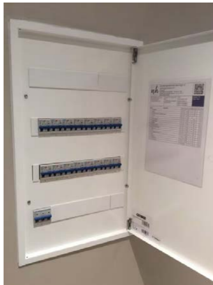
Komplett nyere elektrisk anlegg i boligen.
