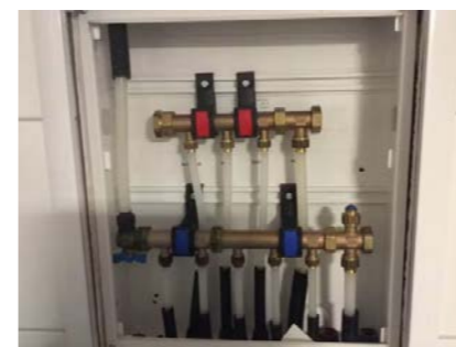
Rørskap i utleiedel.
