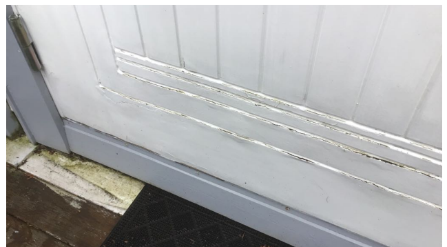
Fuktskader på dørrblad
