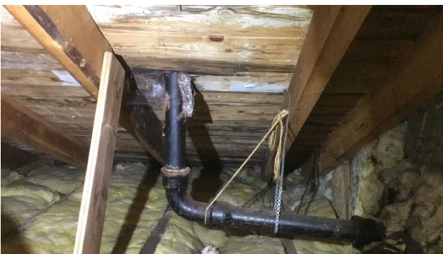
Fukt i undertak ved gjennomføringer
