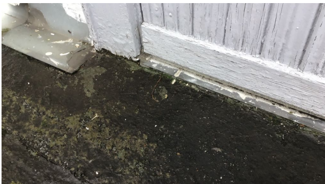
Skader og utetthet i papp tekking
