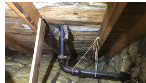
Fukt i undertak ved gjennomføringer
