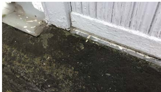
Skader og utetthet i papp tekking
