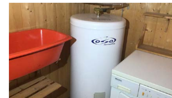
TG 1 Elektrisk anlegg
