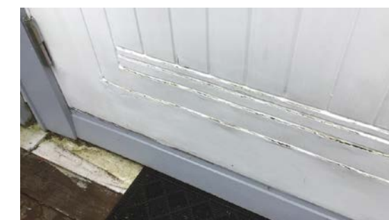
Fuktskader på dørbled
