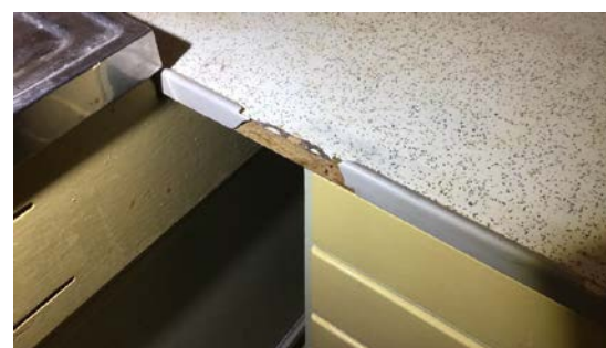
skade i benkeplate
