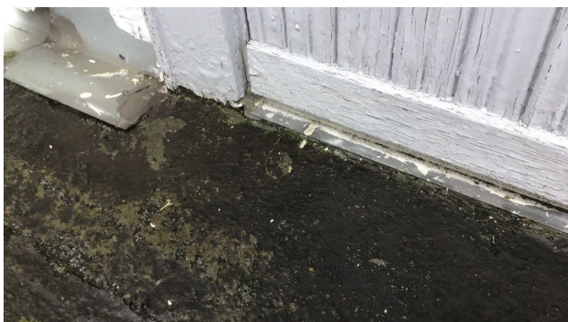
Skader og utetthet i papp tekking
