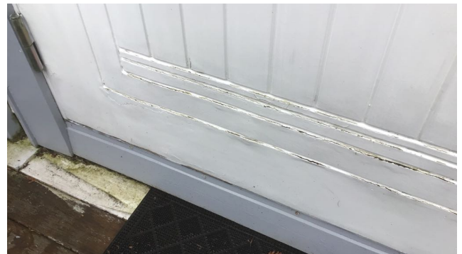
Fuktskader på dørblad
