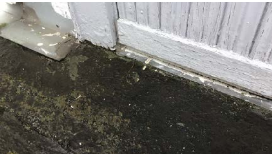
Skader og utetthet i papp tekking
