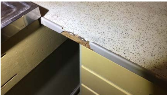
skade i benkeplate
