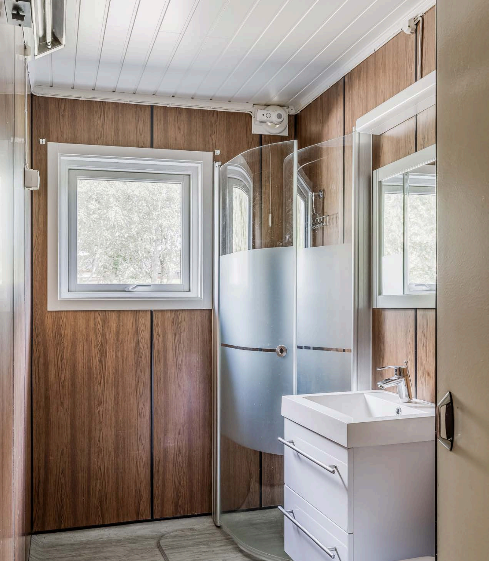
Eldre baderom med vinylbelegg på gulv, baderomsplater på veggene og elektrisk baderomsvifte.
