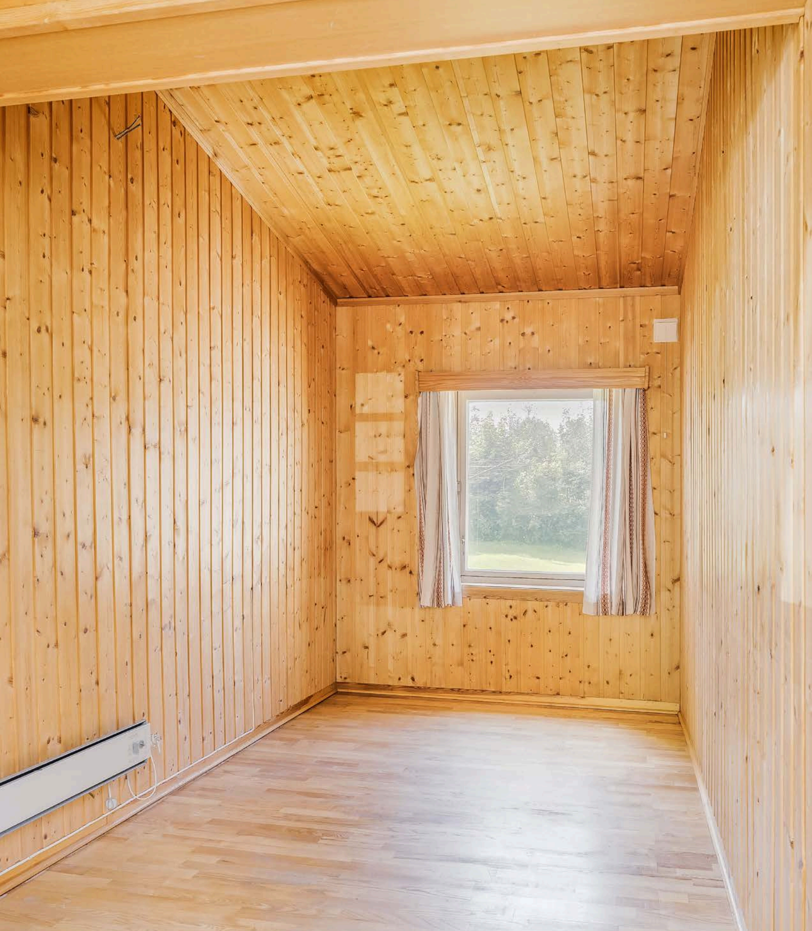
Inntilbygget bod med utvendig adkomst. Tilbygget fremkommer ikke av byggetegningene og antas at ikke er byggesøkt.
