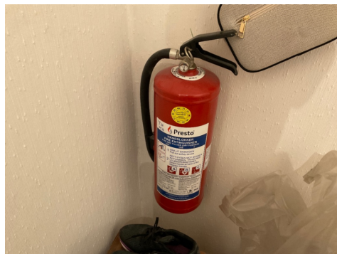
Leiligheten er tilkoblet bygningens brannvarslingsanlegg med en røykvarsler i entreen, brannslukningsapparater er plassert i entreen.
