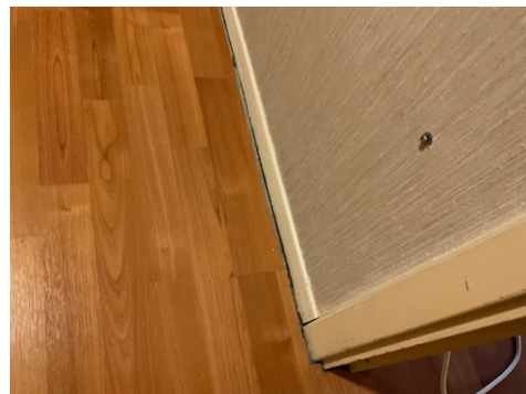
Manglende gulvlist på soverom
