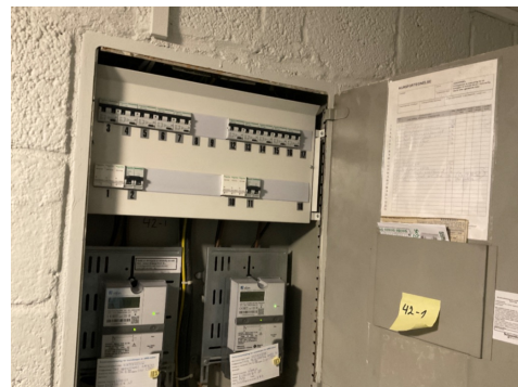
Sikringsskap i felles gang
