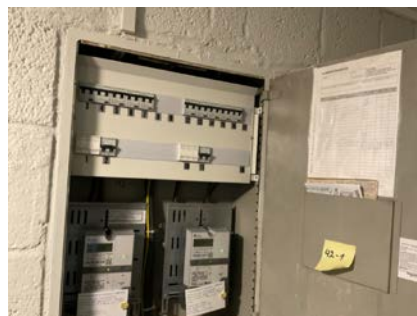
Sikringsskap i felles gang
