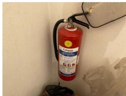
Leiligheten er tilkoblet bygningens brannvarslingsanlegg med en røykvarslar i entreen, brannslukningsapparater er plassert i entreen.
