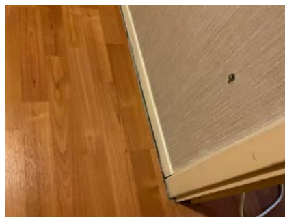
Manglende gulvlist på soverom
