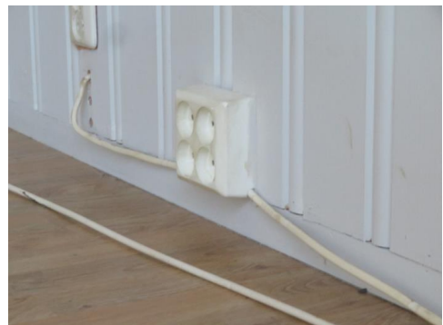
Løse kabler i stue.
