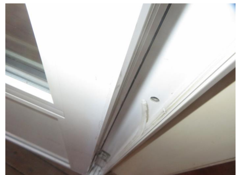
Skadet tetningslist i balkongtdør.
