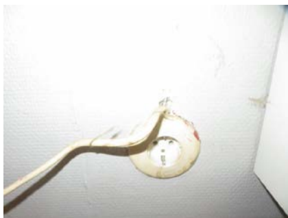
Løs kabel fra stikk på kjøkken til utekontakt.
