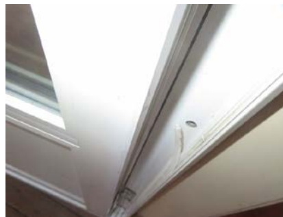
Skadet tetningslist i balkongdør.
