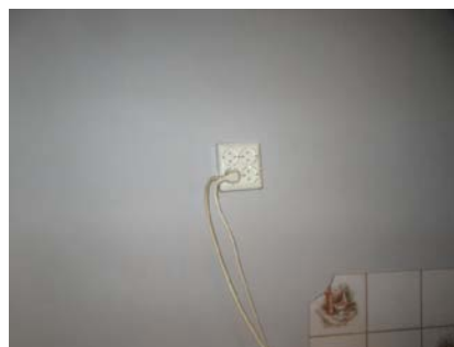
Løse kabel til stikkontakt i bod.
