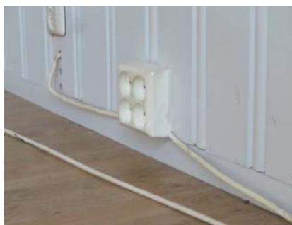
Løse kabler i stue.
