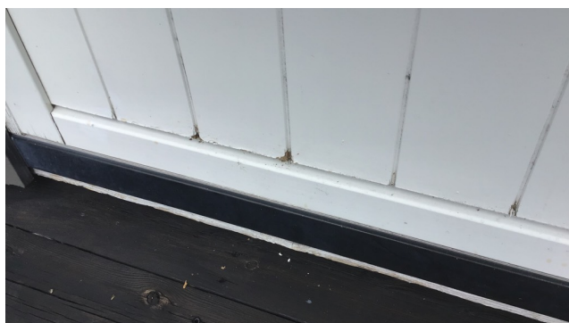
Fukt merker i dørspeil i balkongdør i stue
