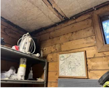
Vannmerker i trepaneler påførte vegger i bod, tilknyttet garasje.
