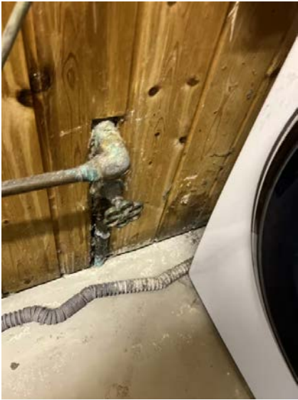
Iring kobber rør, det mangler oppbrett av membran ved rørgjennomføring i gulv. Vannmerker i bunn trepanel på vegg.
