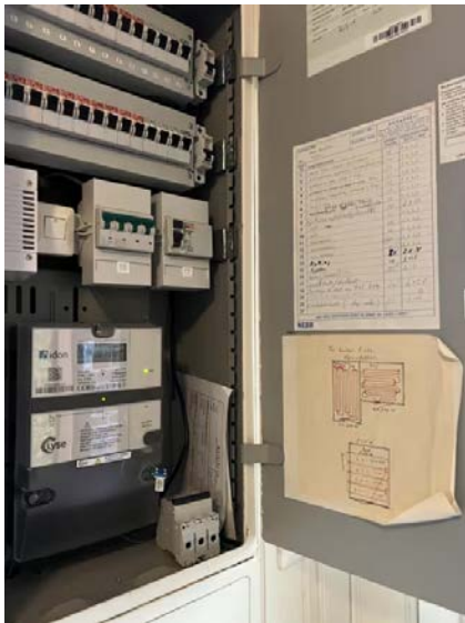
Sikringsskap i entre/gang.
