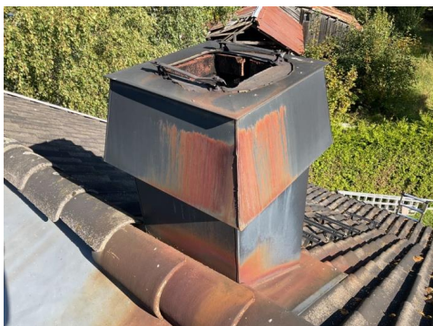
Rust på pipebeslag.
