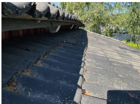
Skjevhet i konstruksjonen.
