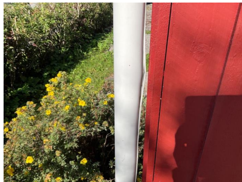
Frostsprengning på nedløpsrør.
