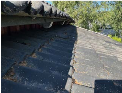
Skjevhet i konstruksjonen.
