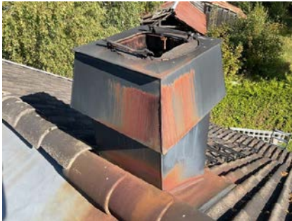
Rust på pipebeslag.
