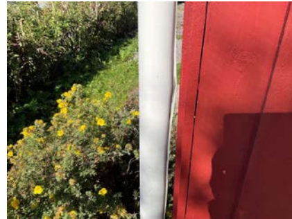
Frostspengning på nedløpsrør.
