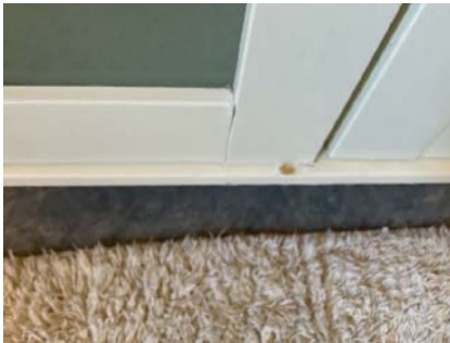
Fuktsvelling på servantskap.
