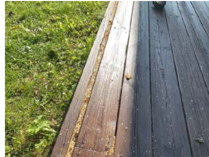
Skjevhet i platting på mark.
