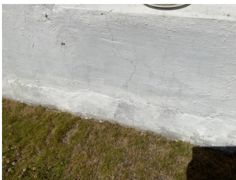
Riss i grunnmur.
