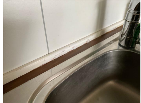
Malingsavskalling på vaskelist.
