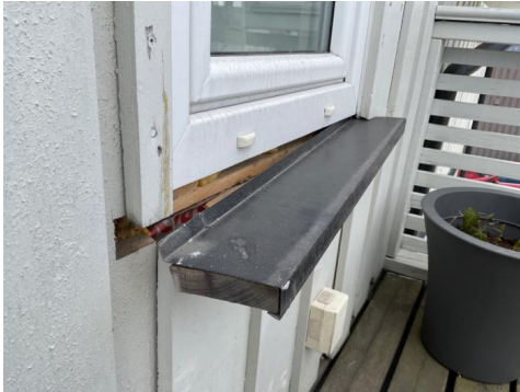
Løst vannbrett og dårlig festet kledning.
