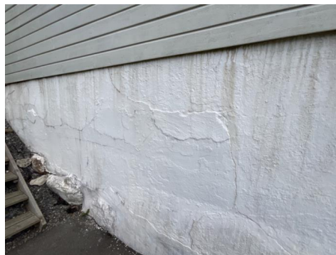
Riss og sprekker i støttemur.
