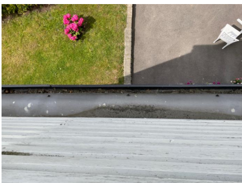
Ufagmessig avslutning av foliebelegg i takrenne.
