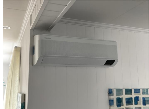
Varmepumpe innvendig del.
