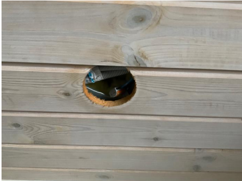
Brutt dampsperre i tak
