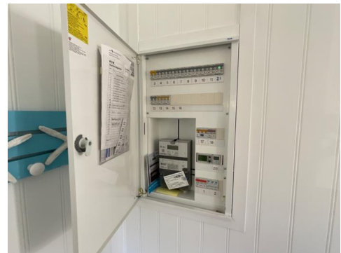
Sikringskap i bolig.
