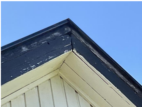
Råte på vindskie.
