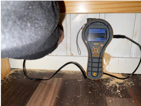
Fuktmåling i vegg.
