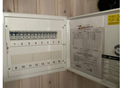
Sikringskap i leilighet
