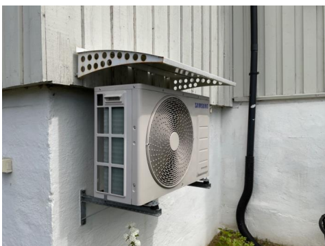
Varmepumpe utvendig del.
