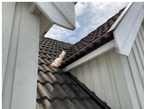
Manglende takrenner på ark/takoppløft.
