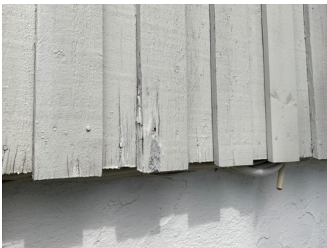
Råte på kledning.
