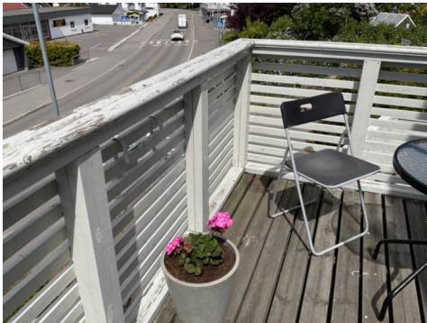
Alder og værslitasje på gulv og rekkverk.
