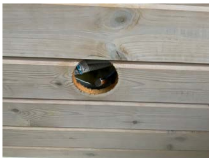
Brutt dampsperre i tak
