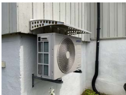
Varmepumpe utvendig del.
