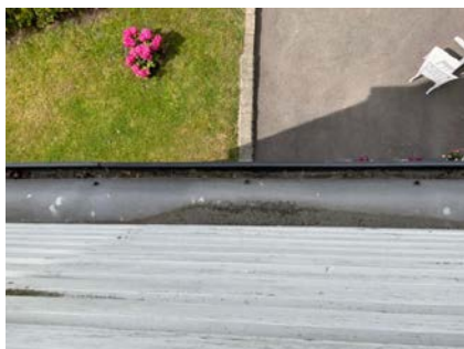
Ufagmessig avslutning av foliebelegg i takrenne.
