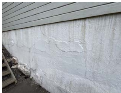
Riss og sprekker i støttemur.
