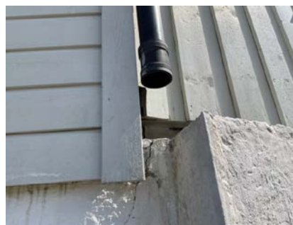
Taknedløp som mangler utkast.
