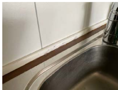
Malingsavskalling på vaskelist.
