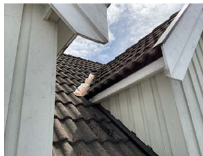
Manglende takrenner på ark/takoppløft.
