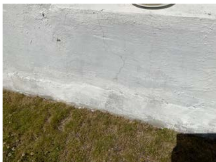
Riss i grunnmur.
