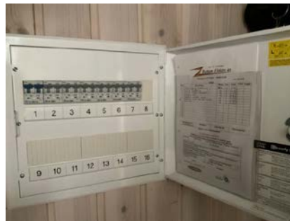
Sikringssskap i leilighet
