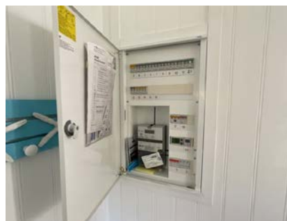
Sikringssskap i bolig.
