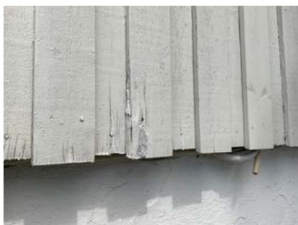
Råte på kledning.
