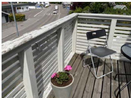
Alder og værslitasje på gulv og rekkverk.
