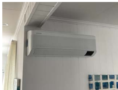
Varmepumpe innvendig del.
