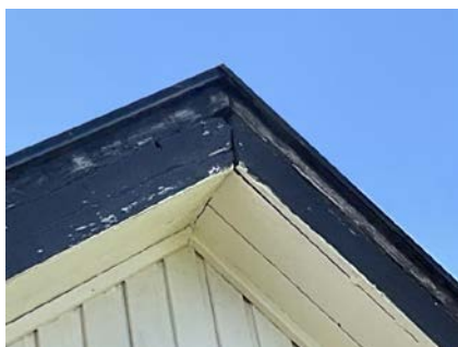
Råte på vindskie.
