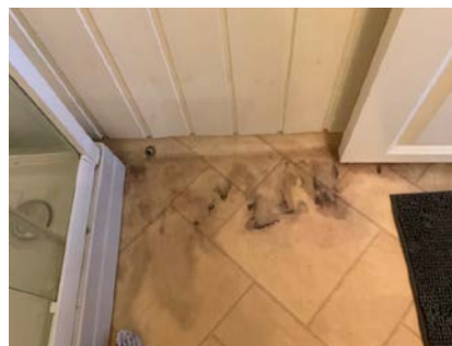
Misfarging på gulvbelegg.
