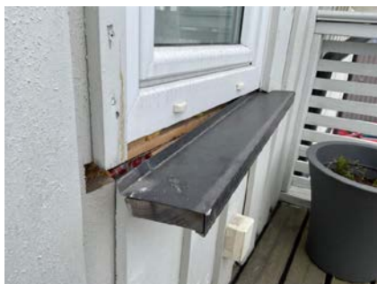
Løst vannbrett og dårlig festet kledning.
