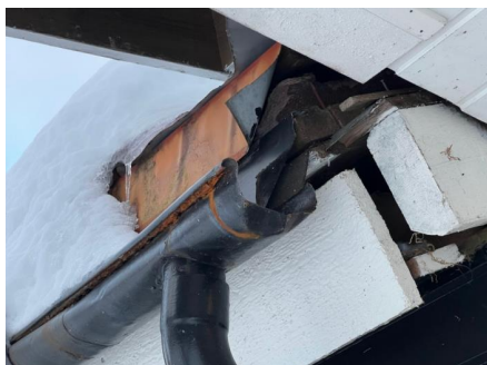
Manglende endestykke på takrenne
