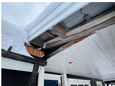
Manglende kledning takutstikk
