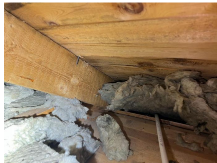
Noe mindre missfarging undertak samt manglende ventilering over isolasjon
