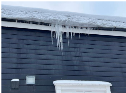
Istapper tak utenfor baderom 2. etasje
