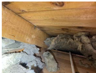
Noe mindre missfarging undertak samt manglende ventilering over isolasjon
