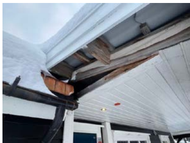
Manglende kledning takutstikk
