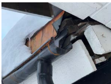
Manglende endestykke på takrenne
