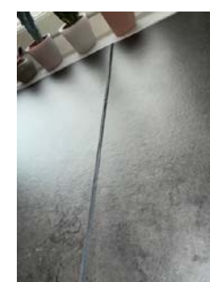
Ujevn plateskjøt og oppsprukket silikon.
