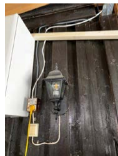
Dårlige og ufagmessige klamrede ledninger/kabler i garasje.
