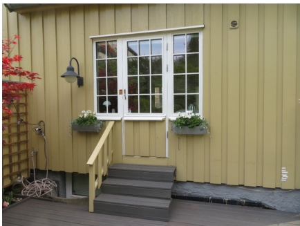
Manglende rekkverk på en side av trappen
