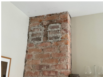
Ventil i luftepipe er tettet/murt igjen.
