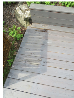
Slitasje-skader på terrassegulv.
